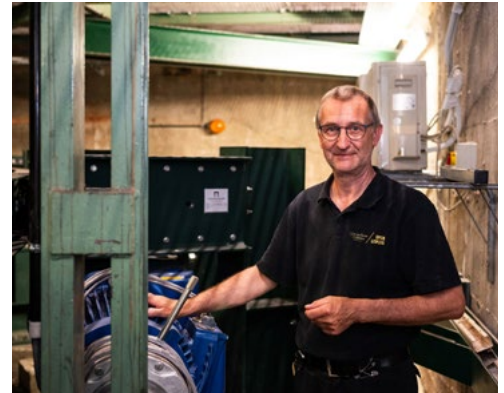
Bühneninspektor Steffen Naundorf vor einem der beiden Motoren für die Kettenantriebe der Drehbühne.
