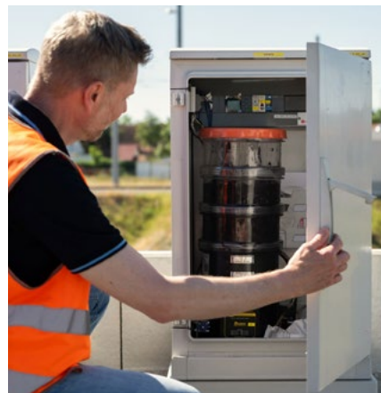
Blick in die Box: Hier befindet sich neben der Anlagensteuerung auch der Trennmittelbehälter.
