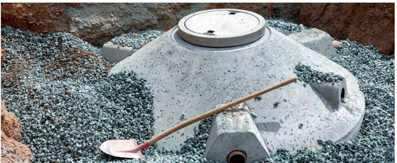
Abbildung 43: Eingebaute Betonzisterne mit sichtbaren Zuläufen
