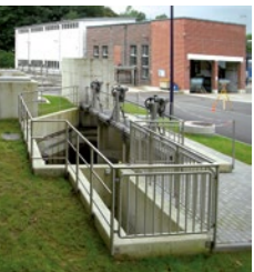
SBW 4 und 5 Klärwerk Rosental
